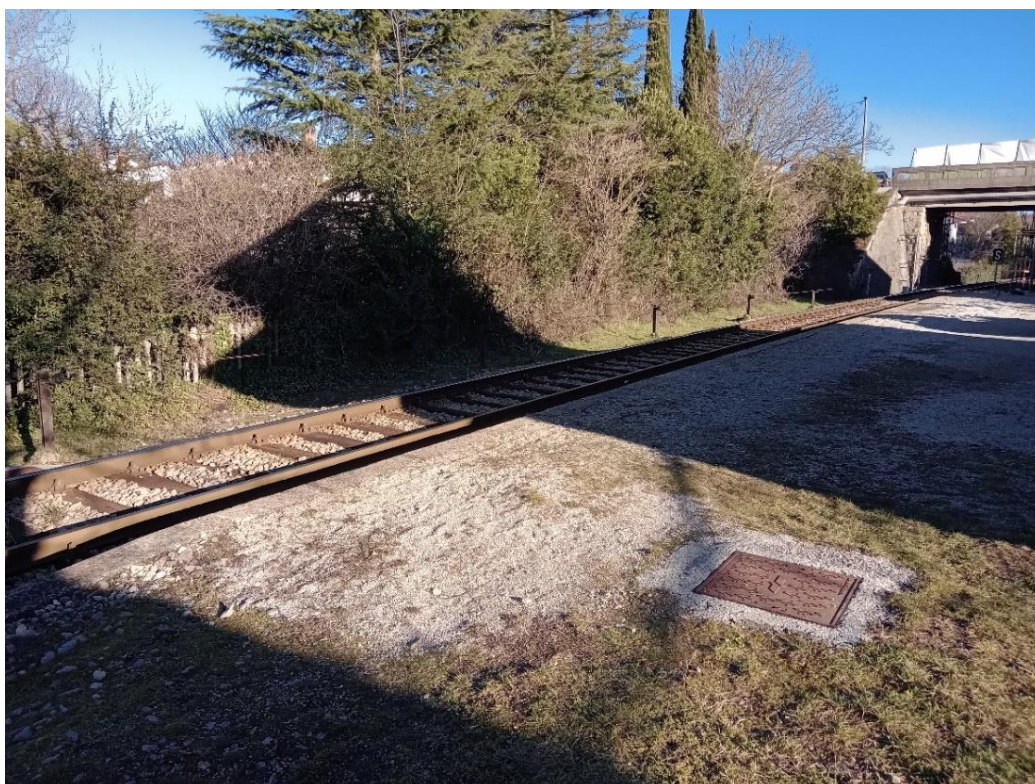
Slika 63: Neprimerna in neutrjena peronska infrastruktura, ki nujno potrebuje nadgradnjo
