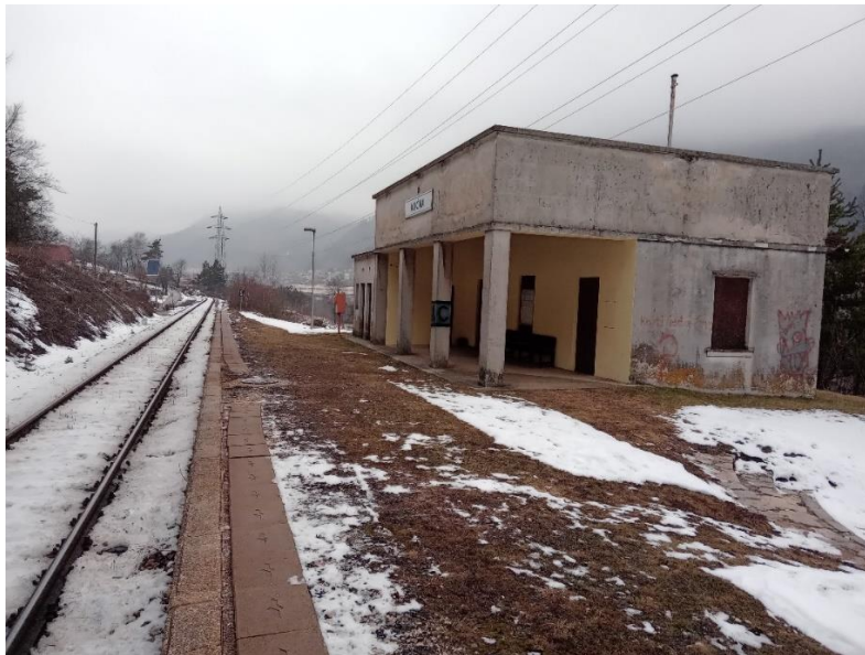
Slika 11: Dotrajana in zanemarjena postajališčna stavba z neprimerno peronsko infrastrukturo
