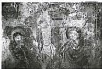
Prizor Križanja smo odkrili pod sekundarnimi ometi na severni steni pevskega kora. Foto: Peter Vernik
