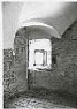
Ob ostenju obrambne line iz začetka 17. stoletja je vidno ostenje starejše obrambne line iz gradbene faze dozidave okroglih stolpov. Na levi strani line je vogal iz klesancev, ki predstavlja vogal nekdanjega prostostoječega dvora. (Foto Neva Sulič Urek)
