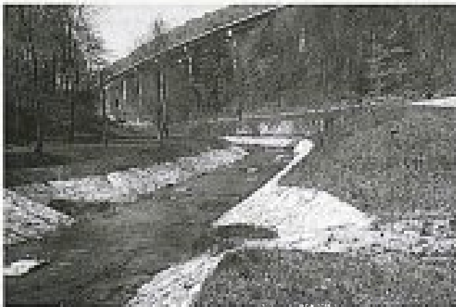
Ureditve struge Žičnice, desnega pritoka Dravinje, v bližini naselja Žiče. Struga potoka je povsem izgubila naravno obliko, potok je ujet v betonsko korito. Ureditev je bila izvedena pod viaduktom avtoceste, ob Žičnici pa je tudi izvir pitne vode Čimerman. Posnetek: A. Tajnikar (april 2003)
