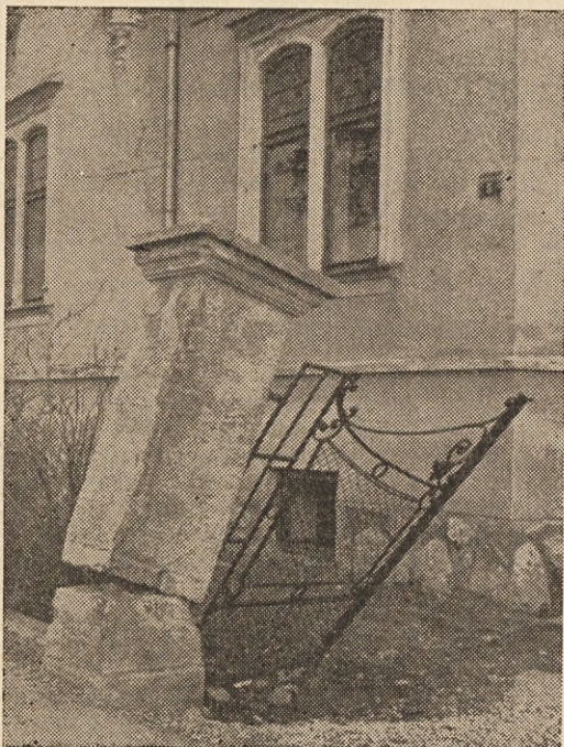
Odločiti se je treba: ali ograjo popraviti ali pa odstraniti. Takšna, kakršna je danes res ne sme ostati! Motiv smo odkrili v Jurčičevi ulici.
